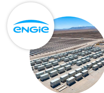
Baterías Bess Coya
