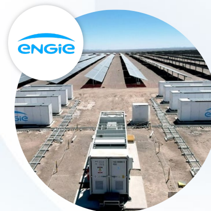
Banco de Baterías Bess Coya
