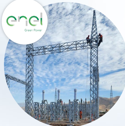
Subestación Don Humberto
