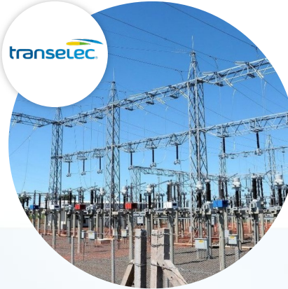
Subestación eléctrica, Buin
